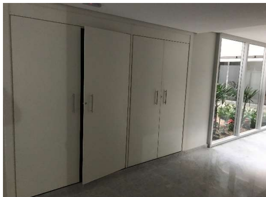
07 – Marcenaria, armários dos quadros de energia.
