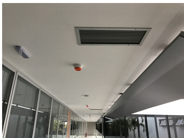
15 – Forro de gesso com pintura, grelhas de troca de ar, iluminação de emergência, luminárias, detectores.
