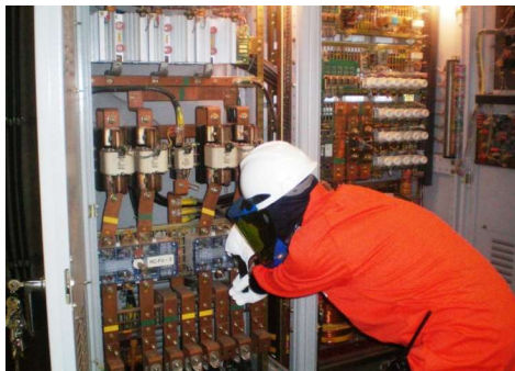
Figure 6 - Atividade em circuito elétrico energizado de BT, sem segregação.
