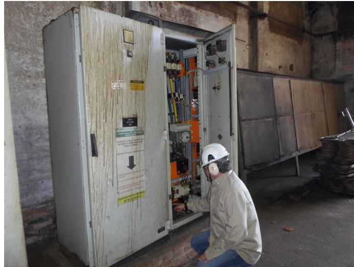
Figura 4 - Painel Elétrico BT "Descopartimentado"
